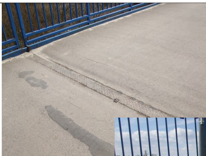
Widoczne nieszczelne dylatacje; przęsłowa i podporowa
