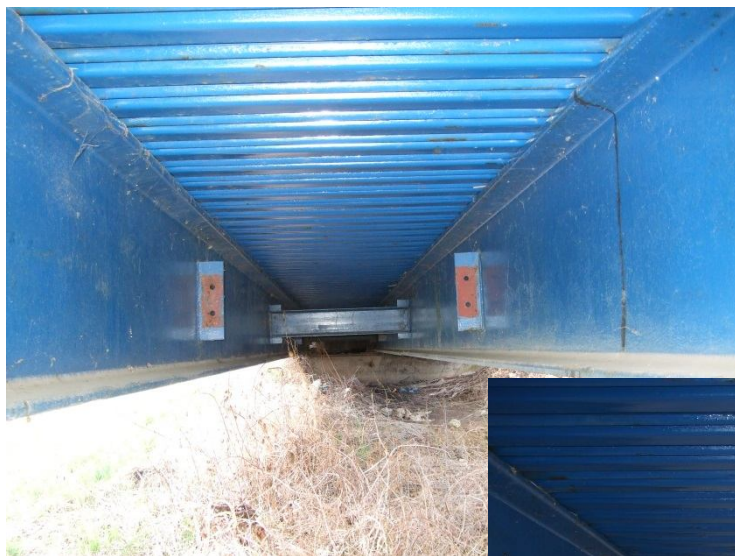
Widoczne brakujące poprzecznice stalowe w przęśle IX
